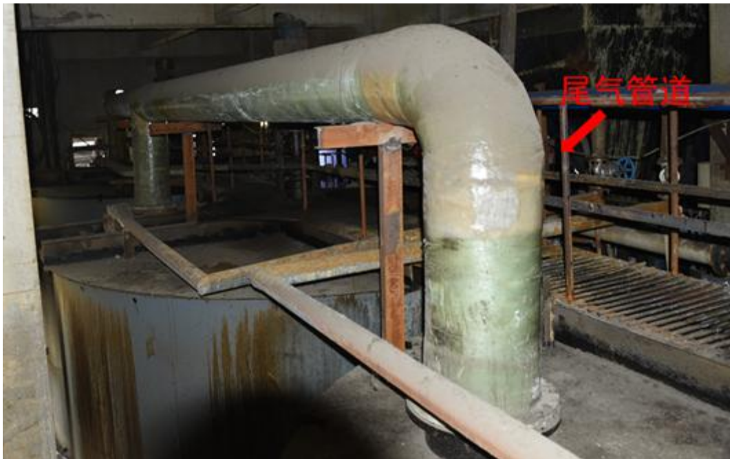
图 6 三座泥浆桶尾气管道相互联通
