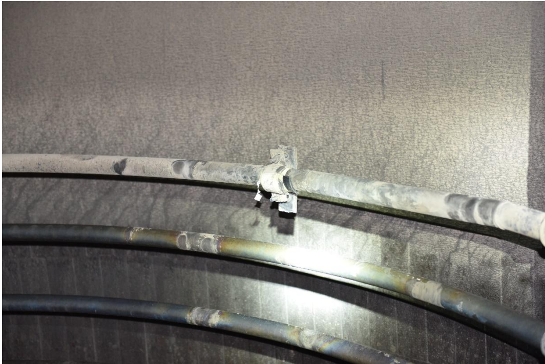
图 8 1号泥浆桶内加热盘管漏点上安装的管卡
