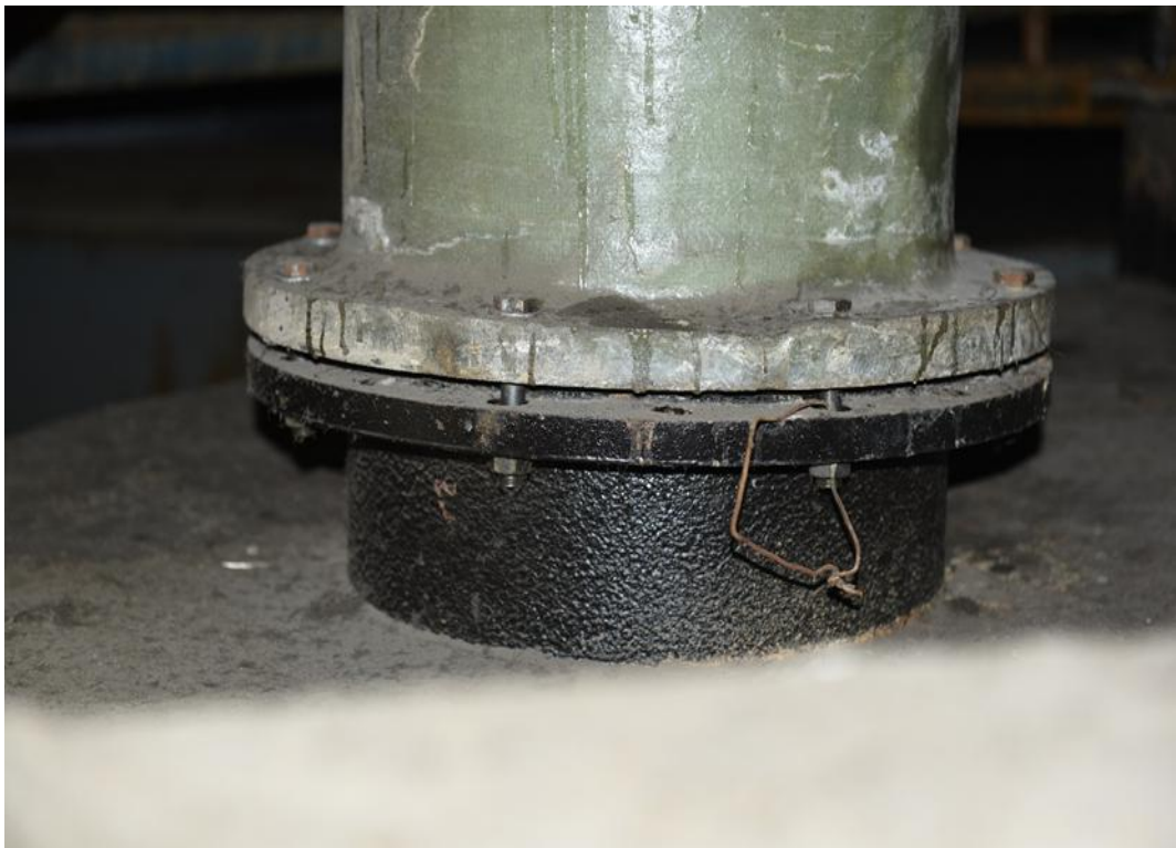
图 9 1号泥浆桶顶部尾气管道未安装盲板
