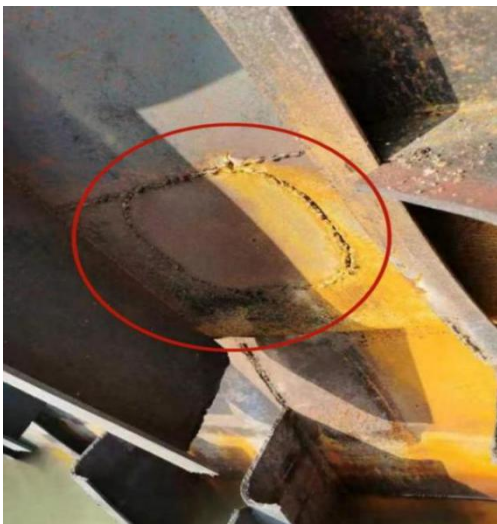
图 9：左舷燃油舱顶板上的补板
