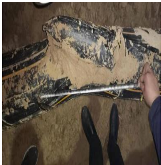
受损燃气管道
