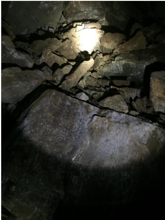
图 2-1 10 月 30 日事故点塌陷情况
