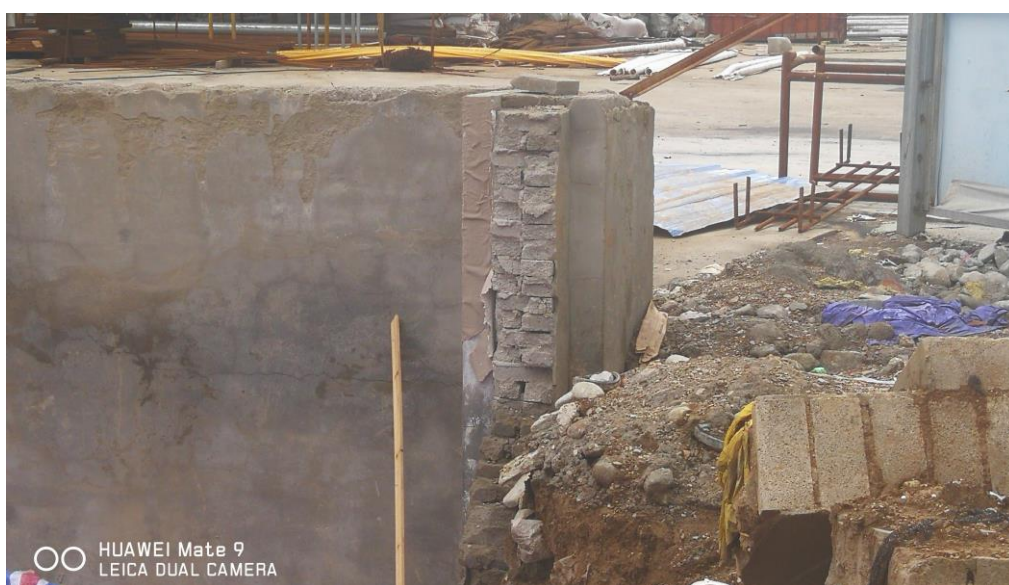
图 7 壁柱与墙体连接节点未见拉结钢筋
